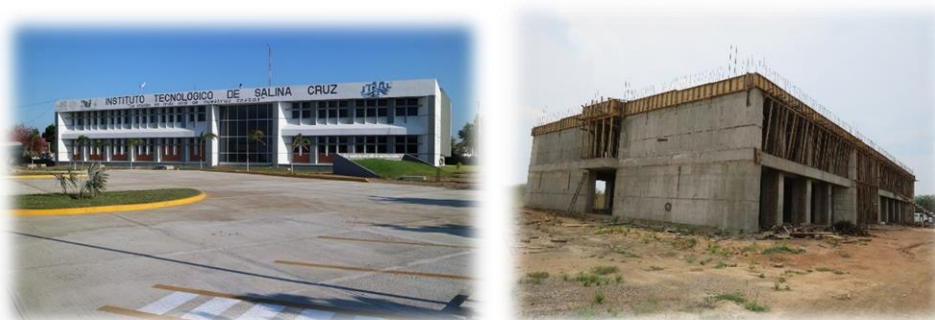
Figura 6. a) Conclusión de la construcción del estacionamiento vehicular; b) Construcción de Unidad Académica Departamental Tipo II
