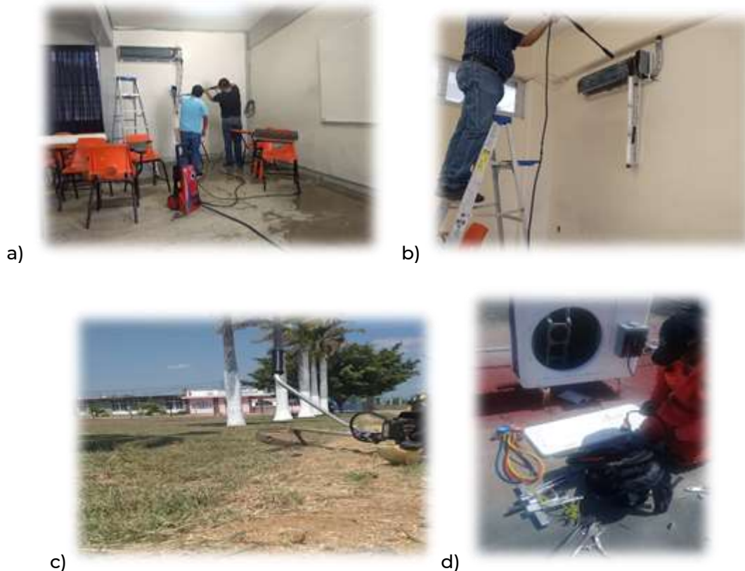
Figura 8. a) Limpieza de aire acondicionado; b) Mantenimiento de aires acondicionados; c) Limpieza de áreas verdes; d) Limpieza del sistema de aires acondicionado
